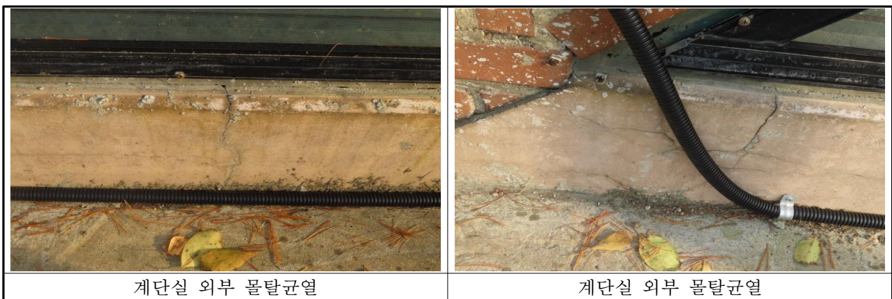
【사진 3.5】 건축구조물 손상사진
