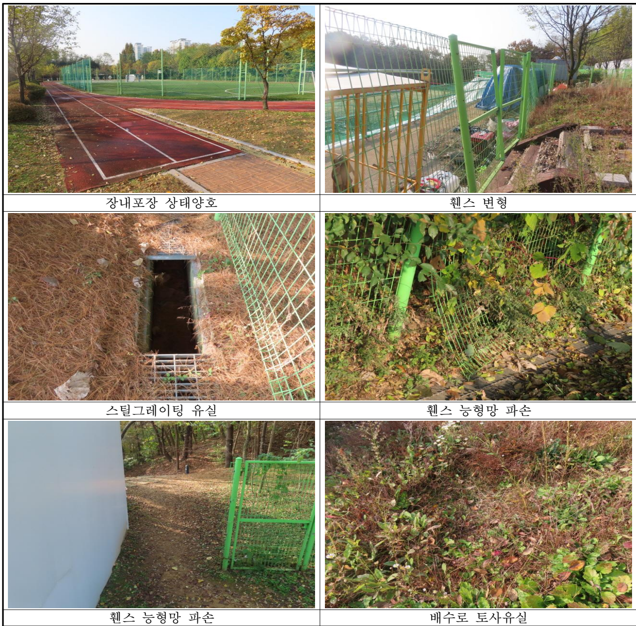
【사진 3.8】 기타 부대시설 손상사진
